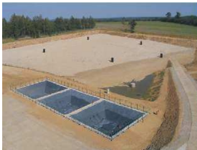
Zbiorniki na odcieki i nowo wybudowana kwatera na odpady inne niż niebezpieczne i obojętne wielkością odpowiadająca potrzebom miasta i gminy Twardogóra
